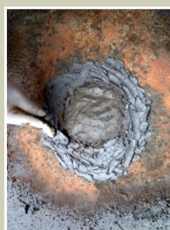
Vazamento contido em 5 minutos
